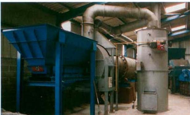
▼ Vue d'ensemble de l'installation
