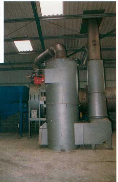
▼ Chambre de post-combustion
