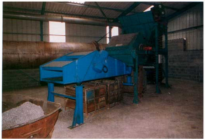
▲ Bloc séparateur : des grosses, des fines, du sable et des tournures
