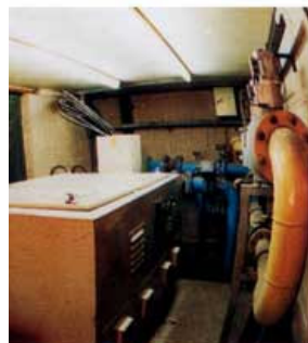
Transformateur de puissance
