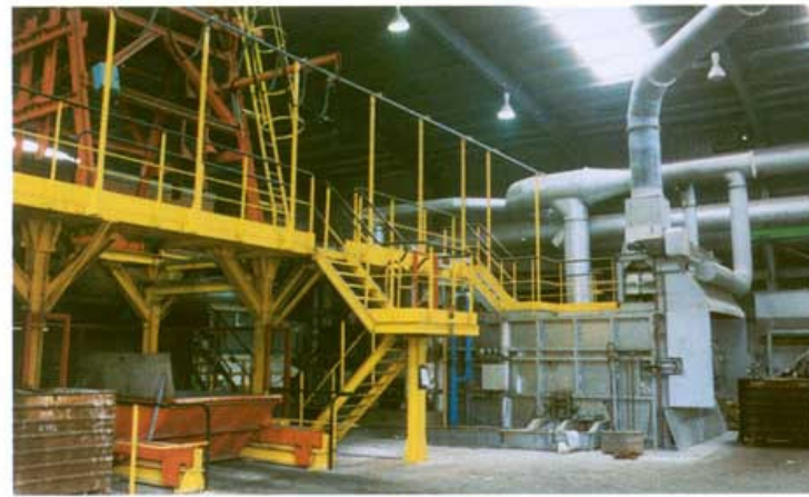
▲ Chargement automatique sur 2 fours TT 4000 en Duplex
